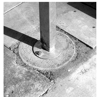
Besser ist die Verankerung ebenerdig auszuführen
