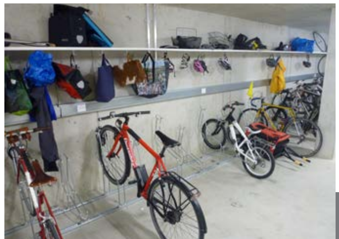
Terra-Plus für zweckmässig ausgerüsteten Velokeller
